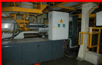
Armadio elettrico SyncroSpeed doppio, montato su Engel ES4400/500
