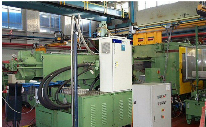
Recinto de SyncroSpeed montado sobre la Negri Bossi NB720 por encima del motor de 90kW. Se mantiene un acceso sin obstrucciones a las bombas y conexiones solenoide.
